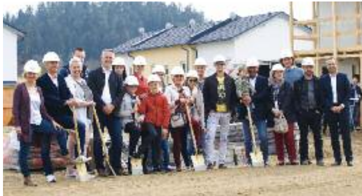
Vor wenigen Tagen erfolgte der Spatenstich zur zweiten Baustufe des Bauprojektes im Ortskern von Lendorf. Foto: KK
