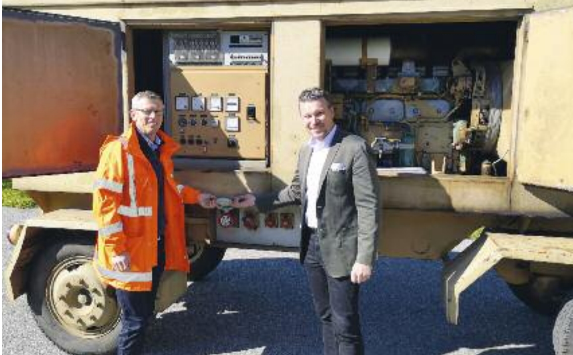
Vizebürgermeister Wolfgang Germ ließ sich das Notstromaggregat vom Geschäftsführer der Kläranlage, DI Gerhard Hohl, im Detail erklären. Foto: StadtPresse/JG
