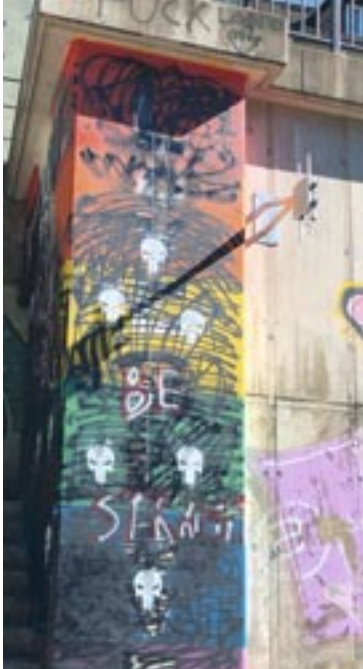
Die Regenbogenwand im Landhafen wurde von Unbekannten beschmiert.
